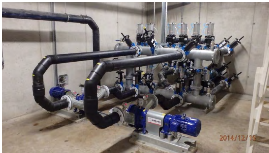
Ilustración 14.- Colector de bombeo con dos bombas centrales.
