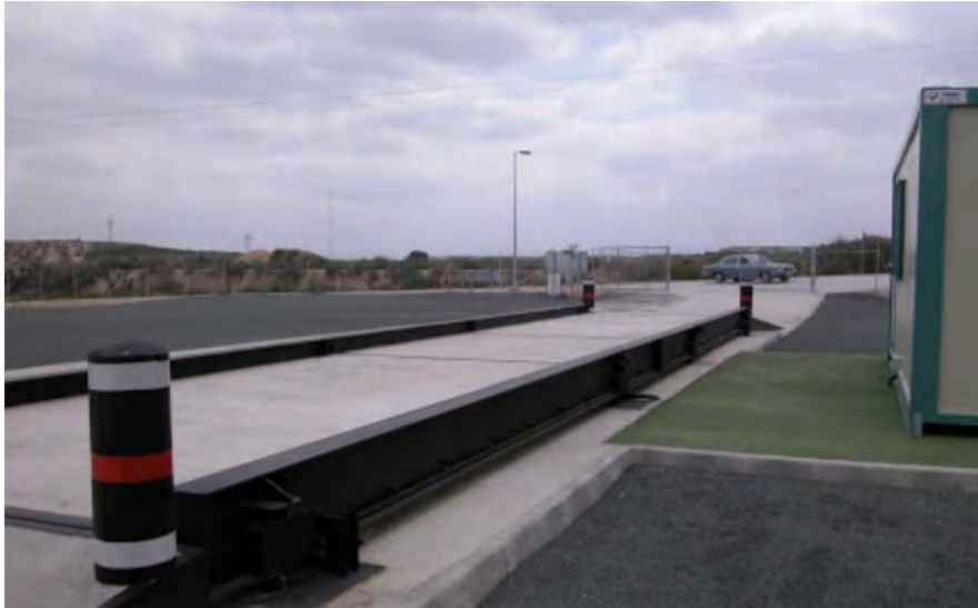
Ilustración 3.- Báscula de pesaje de hormigón.
