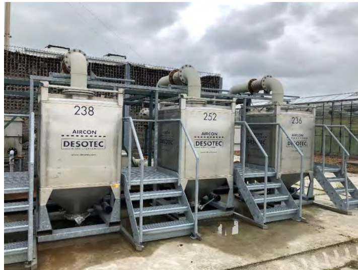
Ilustración 8.- Filtros de carbón activo para la eliminación del azufre y siloxanos presentes en el biogás.
